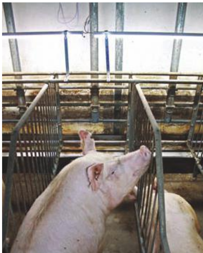
■ LED-armaturerne er nemme at montere og er placeret, så de ikke sidder i vejen.
